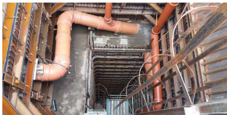
▲ Obr. 5 Obtokové potrubí
