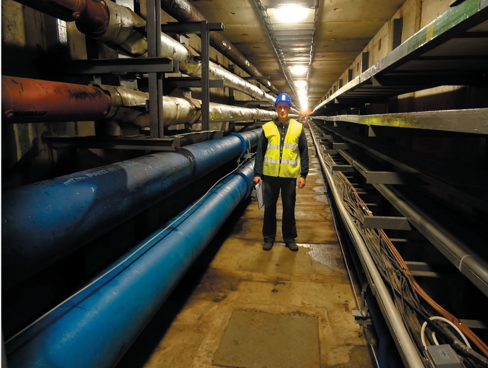
▲ Obr. 2 Obsazenost kolektoru sítěmi
