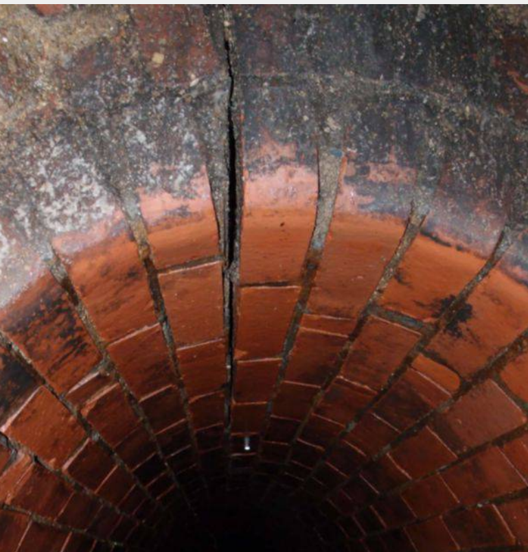
▼ Obr. 1 Trhliny v klenbě
