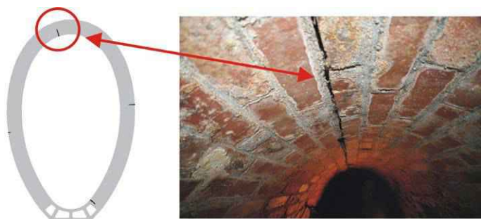
▲ Obr. 8 Porušení stoky
