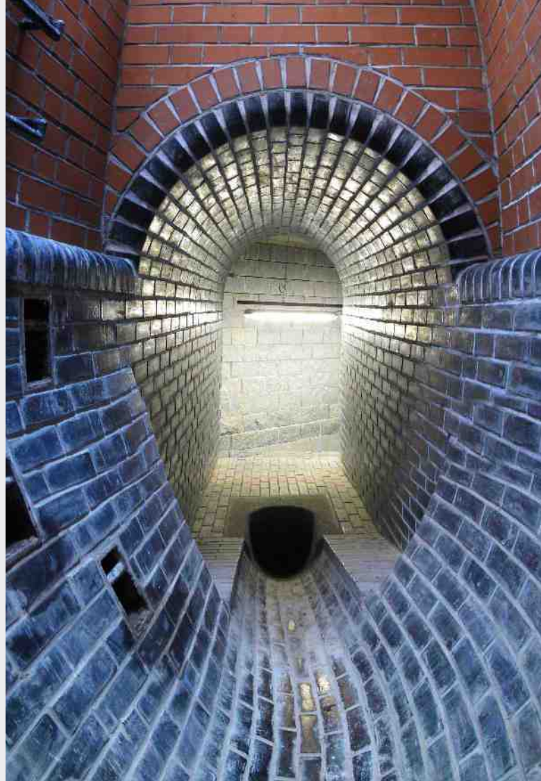
▲ Obr. 3. Nátok do komory spadištěm
