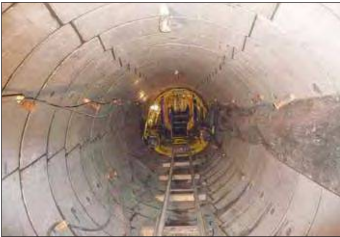
Obr. 5 Tubus tunelu po provedení těsnící injektáže (Bc. Petr Cupal) Fig. 5 Tunnel tube after completion of the sealing grouting (Bc. Petr Cupal)
