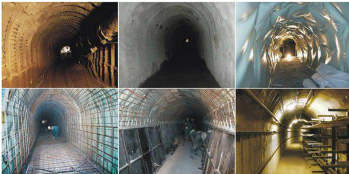
Kabelový tunel Štvanice – technologický vývoj tunelu
