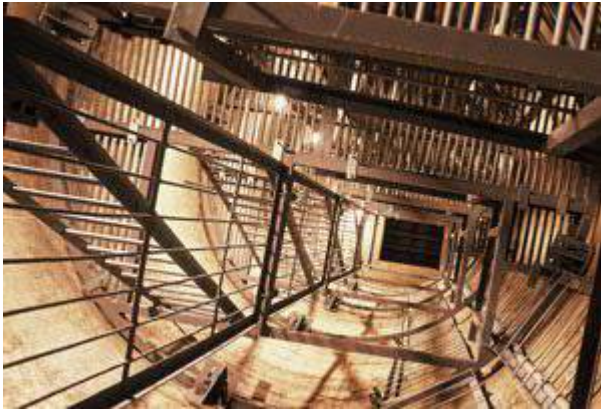
Ocelové vstrojení šachet
