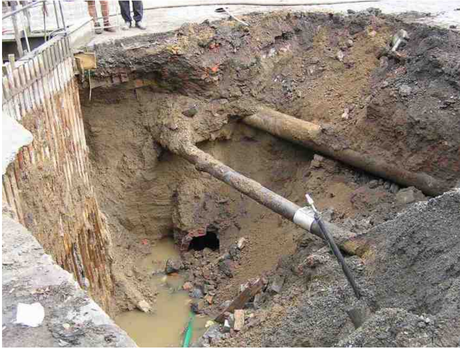
Obr. 3 – Havárie kanalizace Kováků
