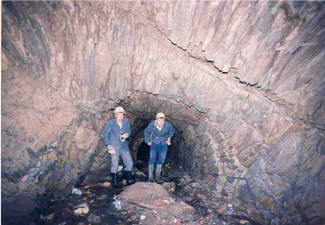
Obr. 1 – Havárie kanalizace Trojská
