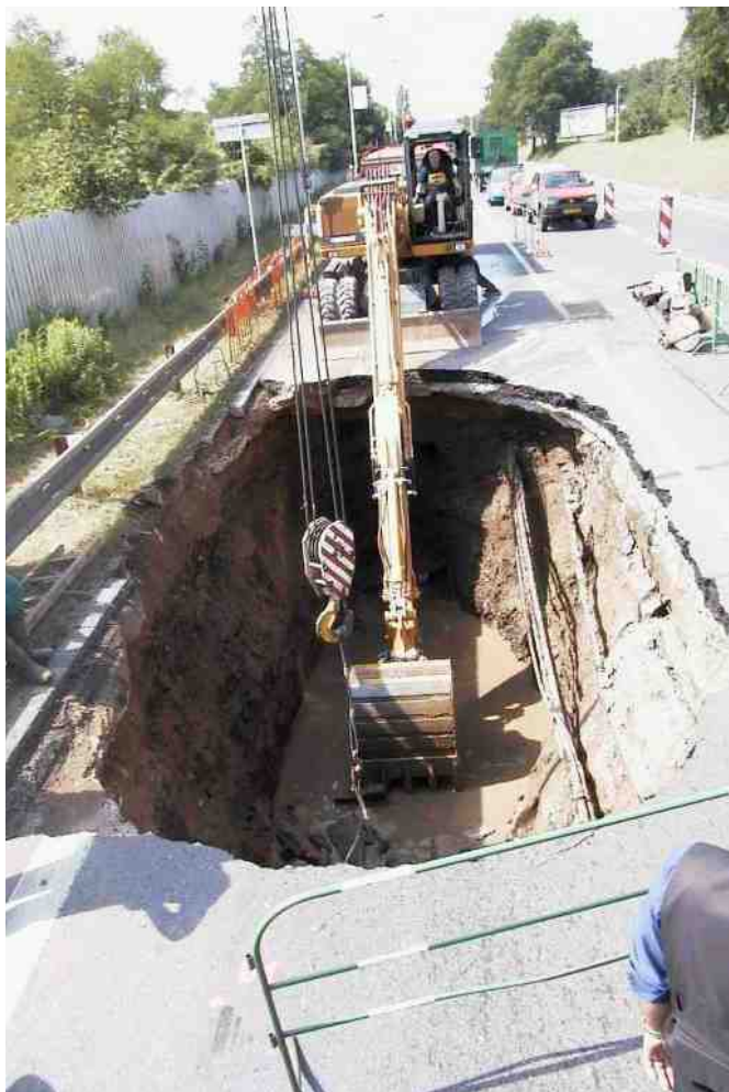
Obr. 2 – Havárie kanalizace Českobrodská
