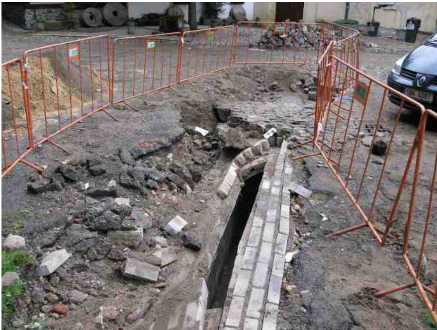
Obr. 4 – Havárie kanalizace Nový Svět
