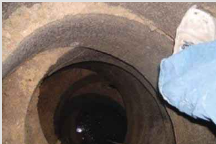
▲ Obr. 2. Stávající havarijný stav konstrukce šachty
