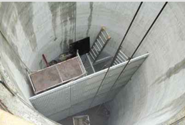
▲ Obr. 9. Šachta je vybavena lezním oddělením z kompozitních profilů
