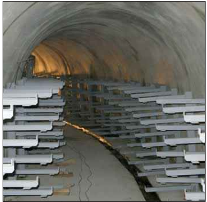
Obr. 7 Montáž ocelových konstrukcí kolektoru Fig. 7 Installation of steel structures in the cable tunnel
